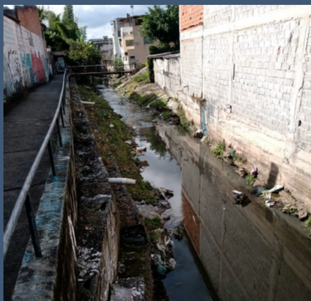
Foto 01: Vista parcial do córrego Maria Paula com em trecho onde é possível a recuperação do talude com a técnica dos muros de gabiões vegetados. Foto tirada pelos autores.
